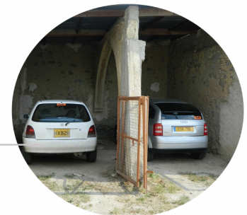
ΑΠΩΛΕΙΑ ΕΞΩΤΕΡΙΚΗΣ ΤΟΙΧΟΠΟΙΙΑΣ ΕΝΟΣ ΔΙΧΩΡΟΥ - ΥΦΙΣΤΑΜΕΝΗ ΧΡΗΣΗ ΤΟΥ ΧΩΡΟΥ ΩΣ ΧΩΡΟΣ ΣΤΑΘΜΕΥΣΗΣ
